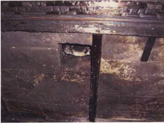
古江台22棟407号室火災 No.310
