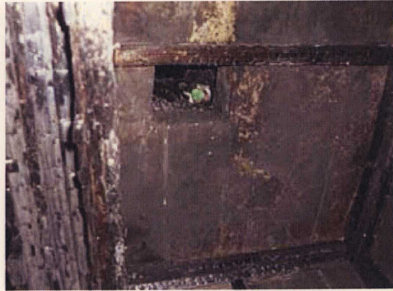
古江台22棟407号室火災 No.320
