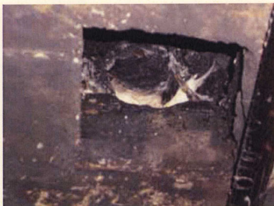
古江台22棟407号室火災 No.360
