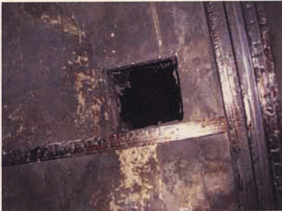
古江台22棟407号室火災 No.330
