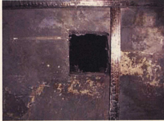
古江台22棟407号室火災 No.350
