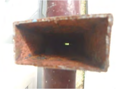
支柱内部の腐食
