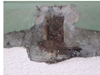
埋込部ベースプレート腐食
