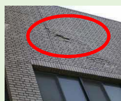
外壁等の剥落の 恐れ
