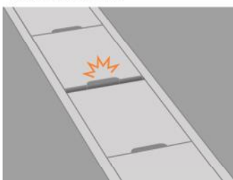
側溝の蓋のすき間
