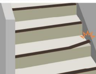
階段の滑り止めの浮き
