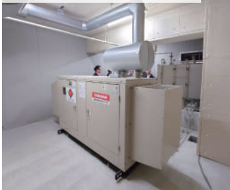
自家発電装置（受水槽室）
