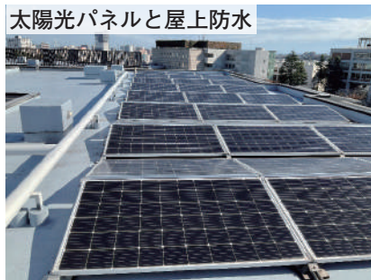
発電状況が確認できるモニタ
