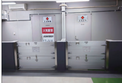
止水板（電気設備室前）
