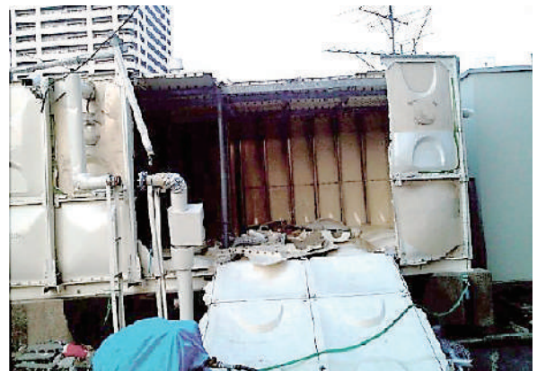
●受水槽の被害（東日本大震災）*2
