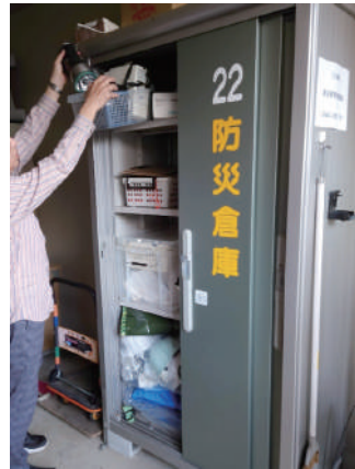
各住棟1階共用スペース（外部）に防災倉庫を設置（事例7）
