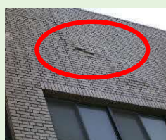
外壁等の剥落の 恐れ
