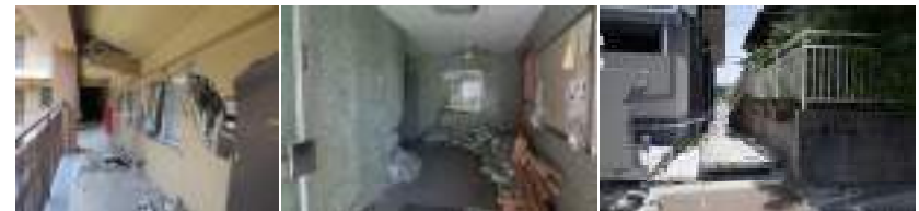
大破したマンションの共用廊下
