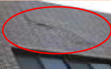
外壁等の剥落の恐れ
