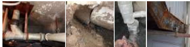
排水設備や浴室防水からの漏水
