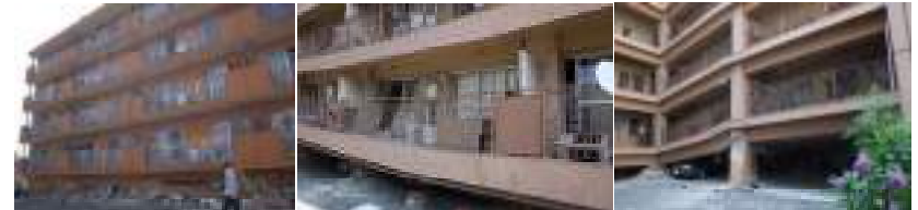
1階部分が圧壊したマンション
