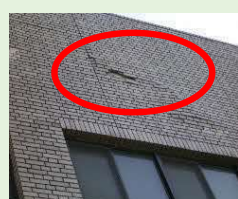
外壁等の剥落 のおそれ
