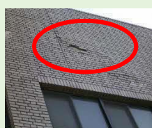
外壁等の剥落 のおそれ
