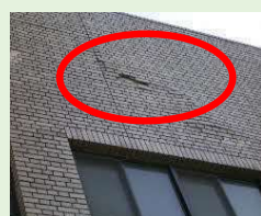
外壁等の剥落 のおそれ
