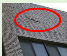
外壁等の剥落 のおそれ
