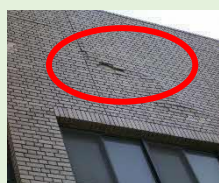
外壁等の剥落のおそれ
