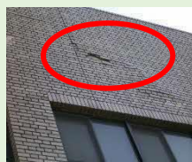
外壁等の剥落 のおそれ
