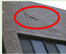
外壁等の剥落 のおそれ
