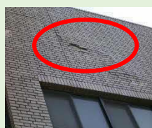
外壁等の剥落 のおそれ
