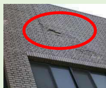
外壁等の剥落 のおそれ
