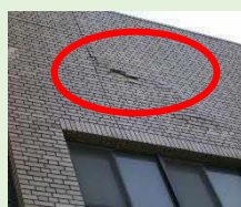
外壁等の剥落 のおそれ
